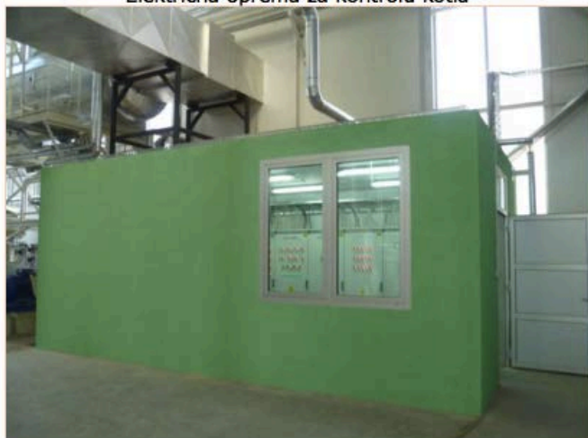
Električna oprema za kontrolu kotla
