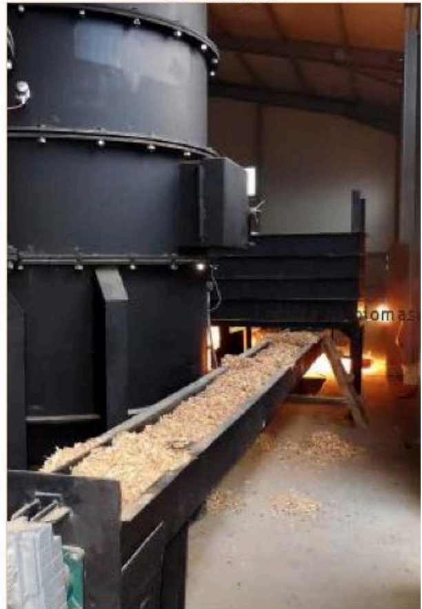
Ložišta za biomasu
