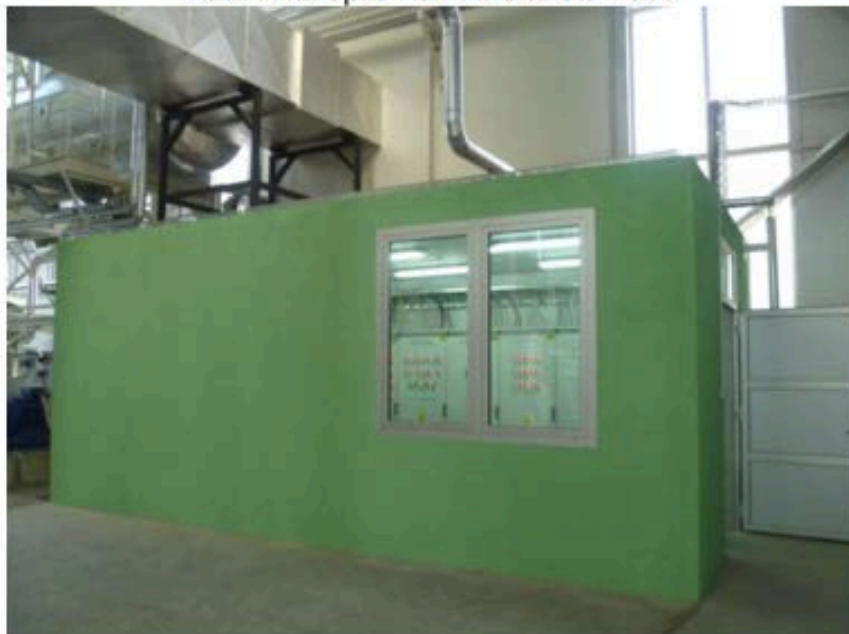
Električna oprema za kontrolu kotla
